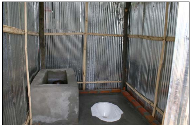
Standard HHC Toilet
